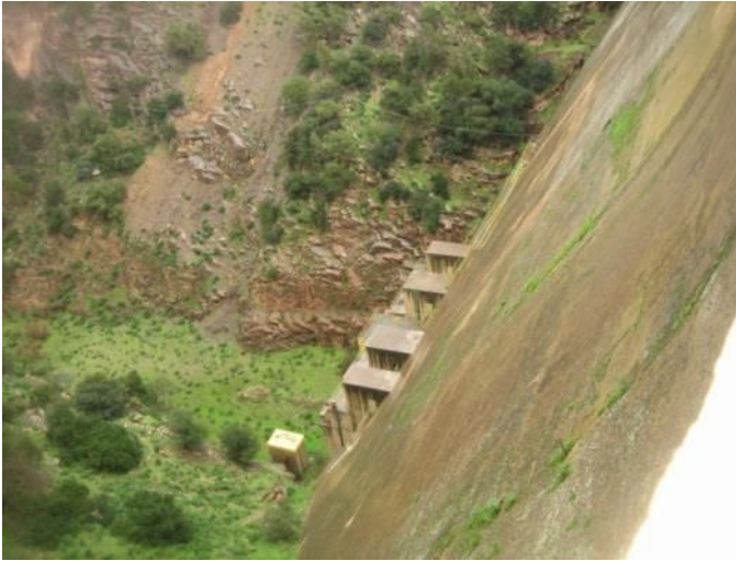
Figure 25 : Batterie de 4 vannettes de soutirage installée au Barrage d'Oued Fodda (cliché. Remini, 2007)
