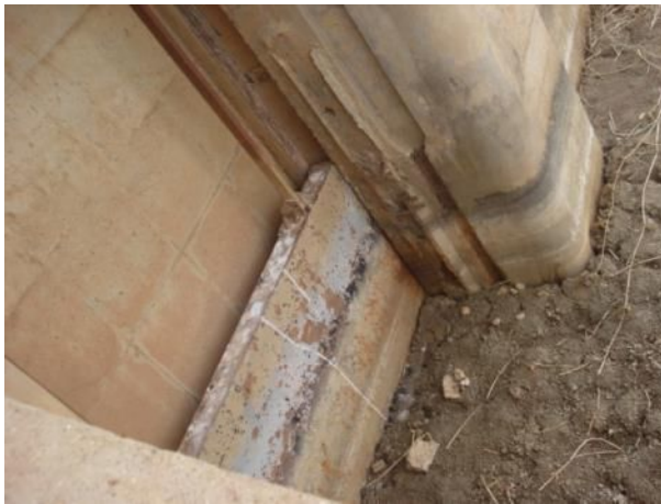
Figure 19 : Blocage de la vanne de fond de la deuxième digue du barrage Bougezoul (cliché. Remini, 2011)
