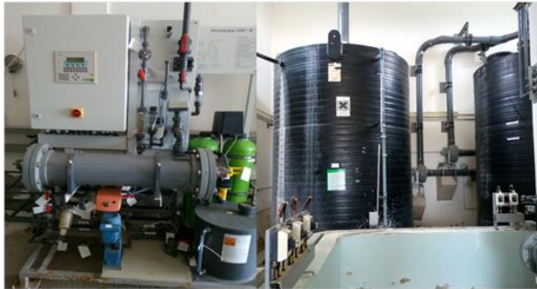
Figure 4 : Unité d'électrolyseur standard de 5 Kg/h, et les bacs de stockage d'hypochlorite de sodium produit dans la station d'Ain Tinn
