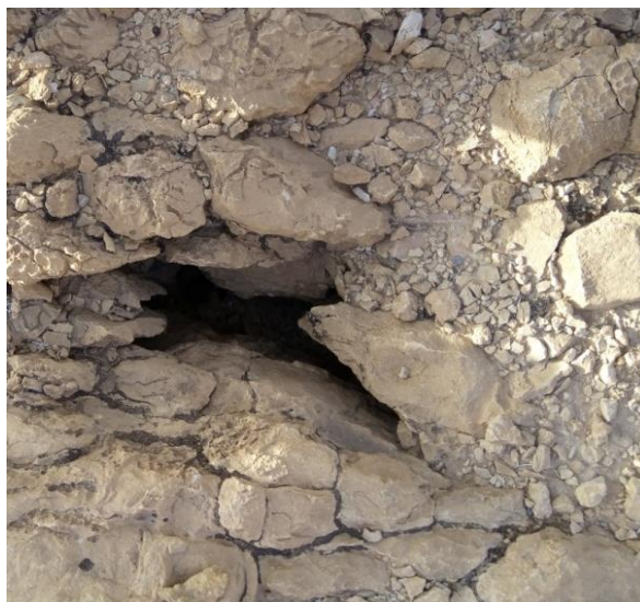
Figure 10 : Grande ouverture au niveau de la roche de la rive droite (photo. 2017)
