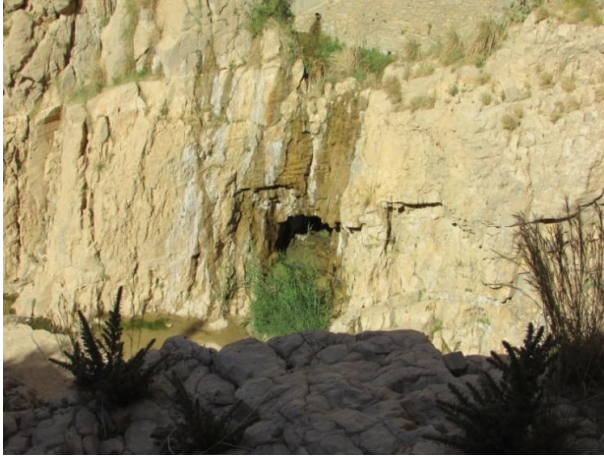
Figure 5 : Ruissèlement des eaux de fuites sur le massif de la rive droite du barrage de Foum El Gherza (Photo. Remini, 2005)
