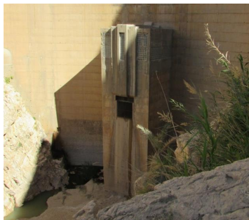
Figure 8 : Vanne de fond du barrage de Foug El Gherza Souvent bloquée Par les palmiers arrachés par les crues (Photo. Remini, Mai 2016)
