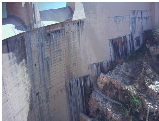
Figure 7 : Une fuite d'eau bien visible bien que le lac est au niveau le plus bas (Mai, 2017)
