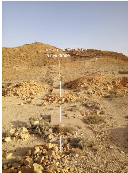
Figure 11 : Traces du rideau d'étanchéité sur la rive droite du barrage (photo. Mai 2017)
