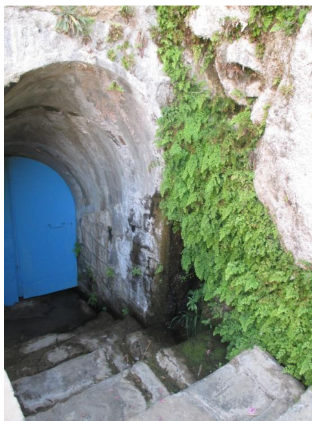
Figure 4 : Résurgences dans la rive gauche du barrage de Foum El Gherza (Photo. Remini, 2017)
