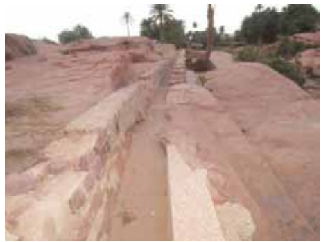
Figure 53 : Une partie de la seguia Foukania Charkia détériorée (photo. Remini, 2009)
