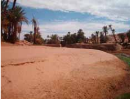
Figure 44 : Dépôt sableux dans la retenue du barrage Foukani en 2008 estimé à plus de 60% de la capacité initiale du barrage (photo. Remini, 2008)
