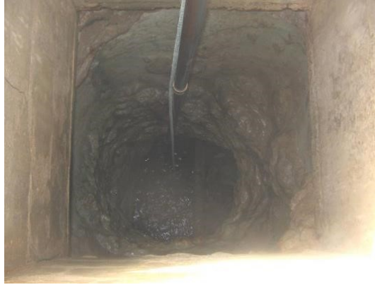
Figure 11 : L'eau dans la foggara de Tindouf, mais elle ne fonctionne pas (Photo. Auteurs, 2013)
