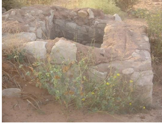
Figure 14 : Des puits qui demandent de l'entretien (Photo. Auteurs, 2013)
