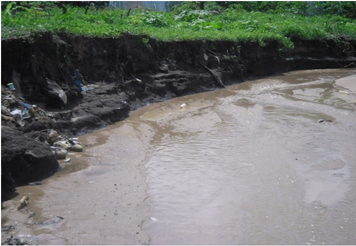
Photo 1 : Dégradation des berges sur la Mfilou Amont
