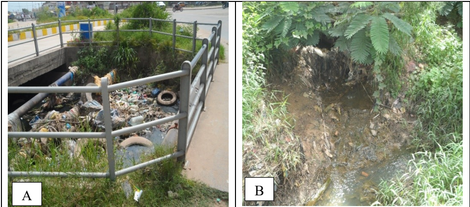
Photo 3 : Canal obstruée par des déchets solides (A), faible débits d’eaux de ruissellements en aval du canal à cause de l’importance de la charge solide (B).
