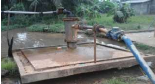
Figure 1 : Etat des équipements en tête de forage (Vanne, débitmètre, manomètre endommagée)
