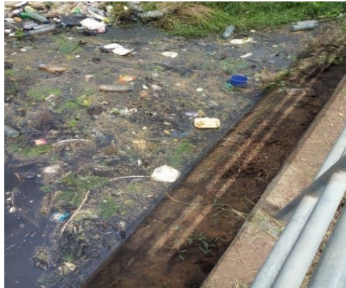
Figure 8 : Etat des collecteurs deux semaines après curage (source: DAHOUNTO Hospice)
