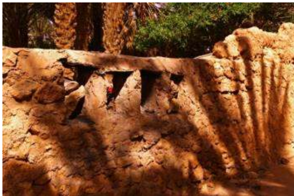
Figure 34 : Dispositif de 4 ouvertures d'évacuation du surplus d'eau vers l'oued Metlili (Photo. Remini, 2019)
