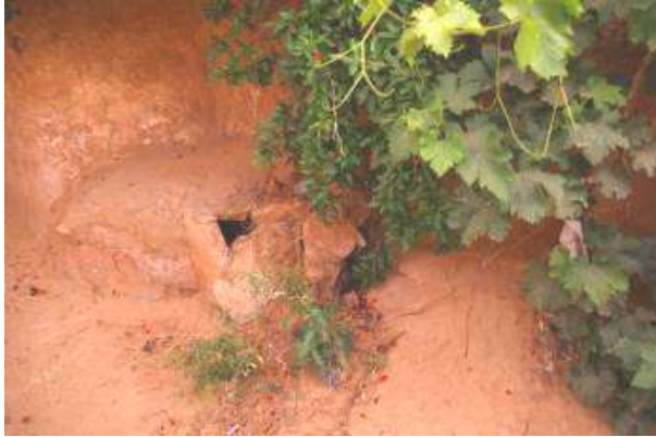
Figure 28 : Une koua bouchée par des blocs (Photo. Remini, 2019)
