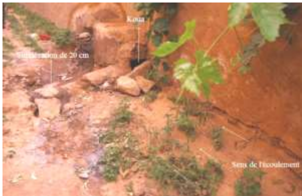
Figure 29 : Une koua fermée par des roches représente un danger pour l'oasis en période de crues (Photo. Remini, 2019)
