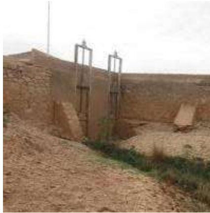
Figure 17 : Pertuis de vidange à double portes coulissantes (Photo. Remini, 2013)
