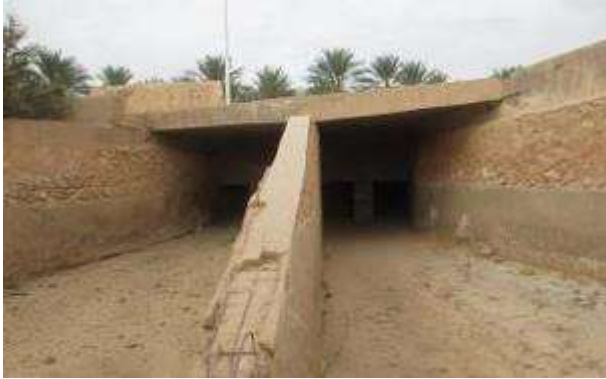
Figure 13 : Partie avale de la première batterie de vannes a portes coulissantes (Remini, 2014)
