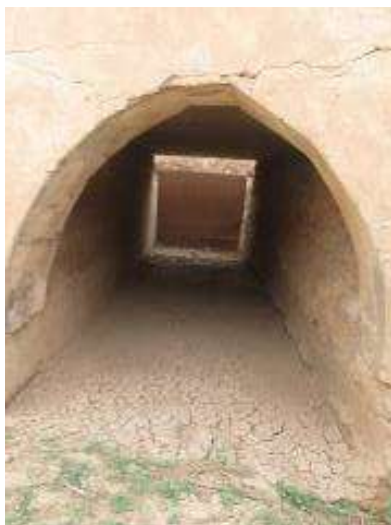
Figure 15 : Vue d'une vanne à porte coulissante (Photo. Remini, 2013)
