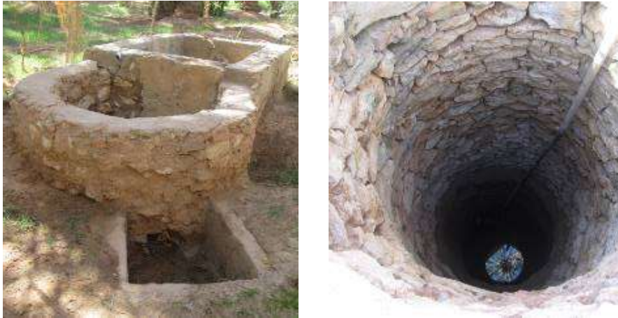
Figure 25 : Puits à double fonction : Puisage et recharge de la nappe dans les oasis d'El Guerrara (Photo. Remini, 2013)
