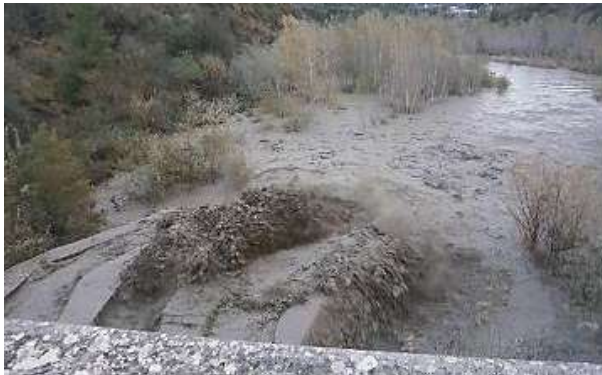
Figure 38 : Une opération de soutirage des courants de densité au niveau du barrage d'Ighil Emda (Photo. Sonelgaz Derguina)
