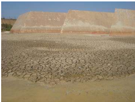
Figure 41 : Boue soustrée par par les pertuis de vidange du barrage de SMBA (Photo. Remini, 2014)
