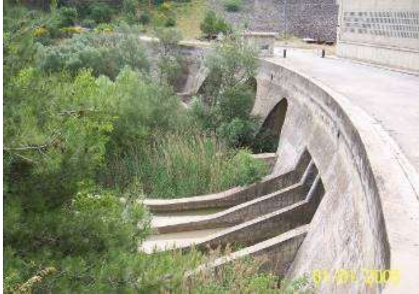
Figure 36 : Batterie de 8 vannettes de soutirage des courants de densité du barrage d'Ighil Emda (Photo. Ouaret et Remini, 2008)
