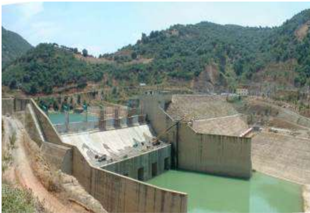
Figure 33 : Surélévation du déversoir du barrage de Beni Amrane par les hausses fusibles (Photo. ANBT)
